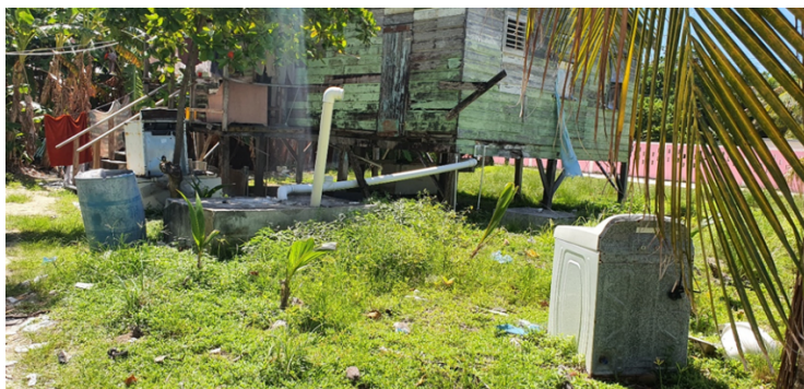
Figura 1: Tanque séptico sobre el nivel del suelo en Cayo Corker, Región Sur. Fotografía ©GIZ/AKUT
